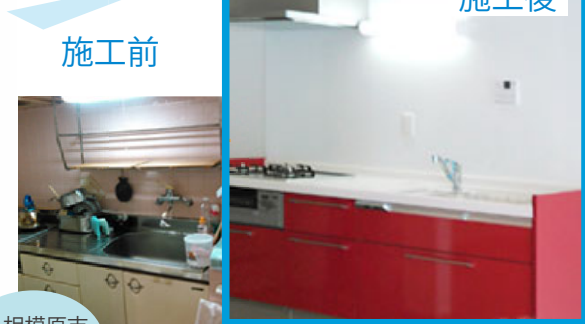
相模原市 Y様邸 建設当時の台所をシステムキッチンにリフォーム
