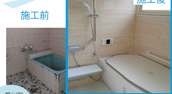
愛川町 Y様邸 暖房乾燥機、自動洗浄浴槽、床洗浄でお手入れが楽に
